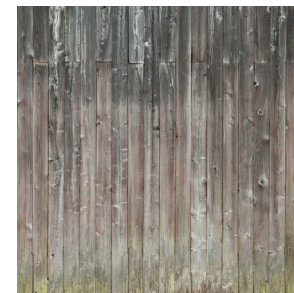
Stávající dřevěná prkna
