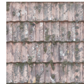
Stávající krytina Vlnovka Lokálně vyměněna
