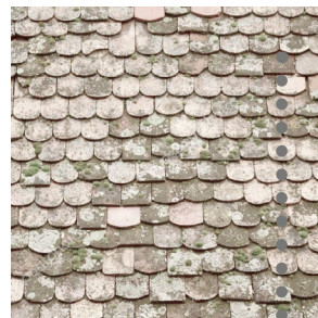
Stávající krytina Bobrovka Lokálně vyměněna
